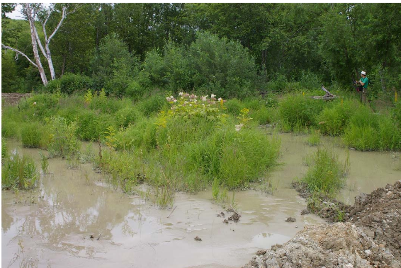
Участок пруда-отстойника с отсутствующей обваловкой крупным планом. Виден поток воды, насыщенной взвесью, стекающей вниз по склону. Справа и слева видны окончания обваловки.
