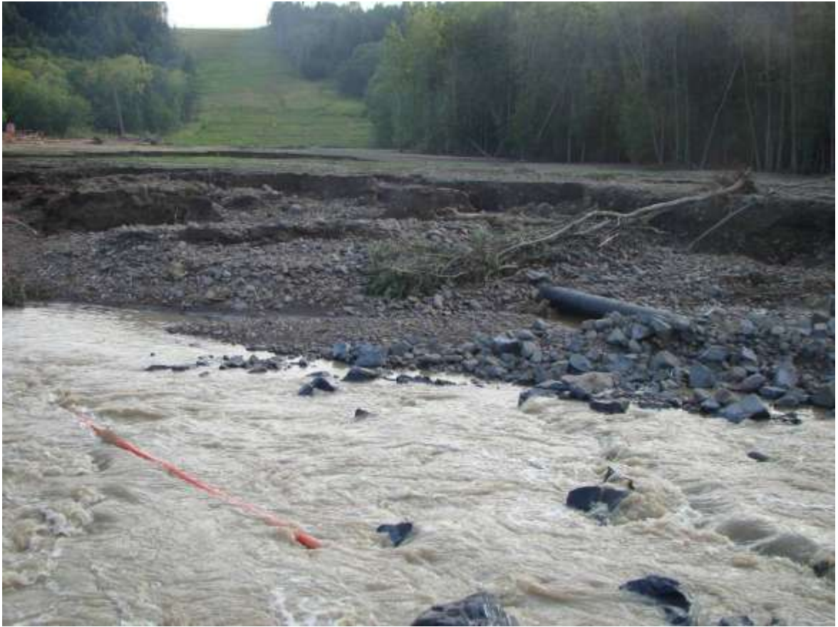
Рис.1. Река Горная после прохождения циклона 21-22 августа 2009 г. Вскрытая нефтяная труба и оплетка оптоволоконного кабеля связи - в русле реки.
