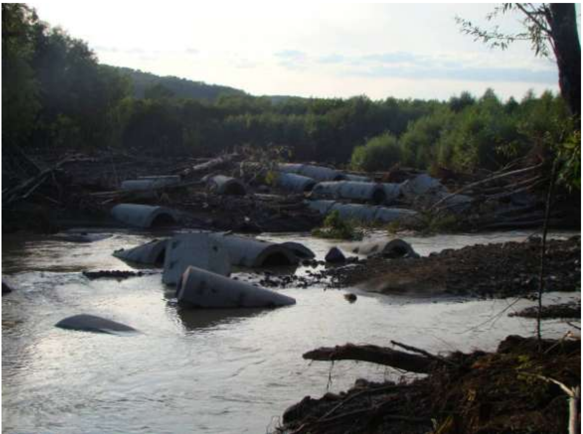
Рис.2. Река Горная после прохождения циклона 21-22 августа 2009 г. Нижний бьеф дамбы: в качестве основного строительного материала использованы утяжелители для трубопроводов. При прорыве дамбы отдельные бетонные блоки протащило течением по руслу протоки около 100 м.
