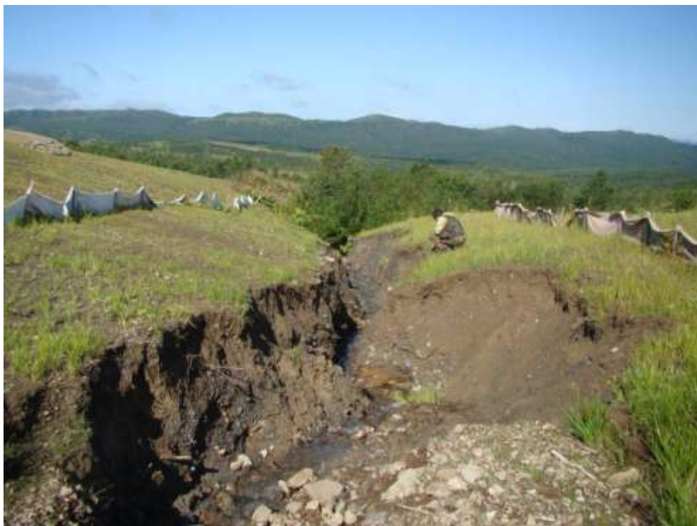
Рис.3. Ручей под хребтом Жданко на 433 км трассы трубопроводной системы после прохождения циклона 21-22 августа 2009 г. Глубина эрозионного вреза достигла 3,2 м., при ширине 4,0 м.
